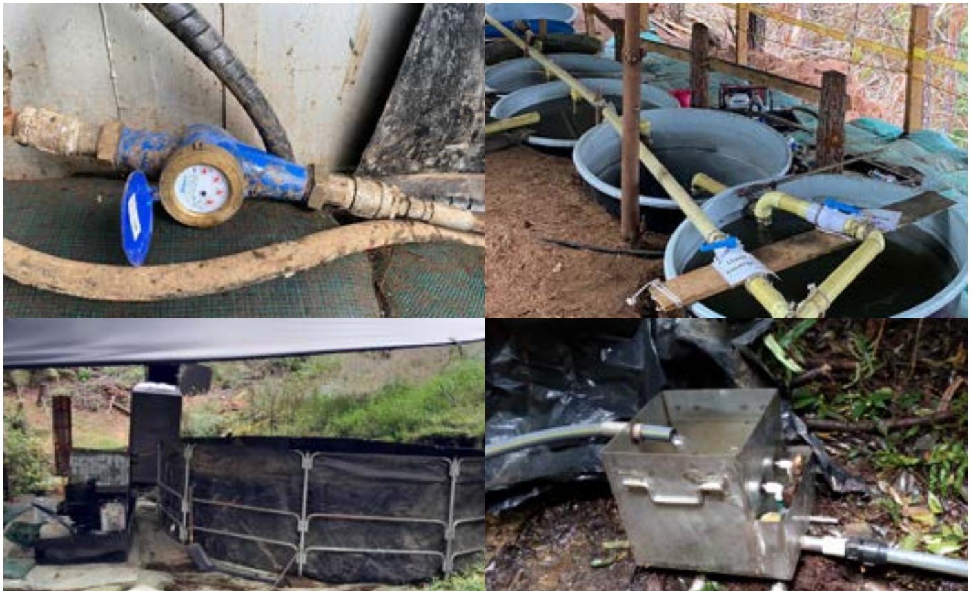
Sistema de captación de agua industrial - Fuente: Minera de Cobre Quebradona S.A.S BIC, 2023
